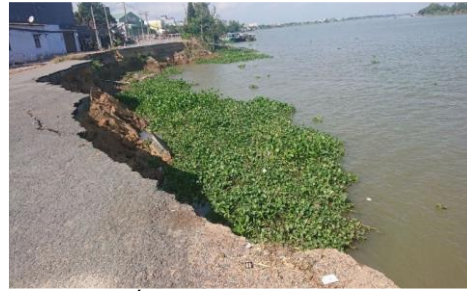
Sạt lở Quốc lộ 91 (bờ sông Hậu) đoạn qua huyện Châu Phú, An Giang
