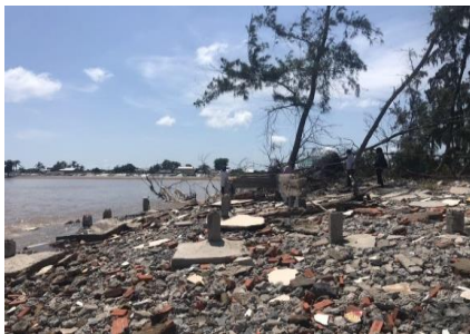
Sạt lở bờ biển Cồn Lợi, xã Thạnh Hải, huyện Thạnh Phú, Bến Tre
