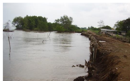
Sạt lở bờ biển khu vực Hòn Quéo, huyện Hòn Đất, Kiên Giang
